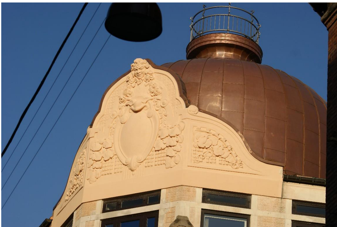
Her ses kuplen med stærk sol på. Det er her alle eventuelle fejl kommer til syne. Som det ses, er udvidelsen i felterne helt homogene, det betyder at kobberet på kuplen er lagt helt stressfrit op.
